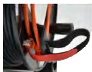
Klettbander für die Fixierung der Patchkabel
