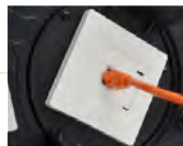
Datendose zum Anstecken eines Patchkabels
